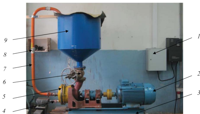
Рис. 1. Общий вид диспергатора роторно-пульсационного типа: 1 – щит управления; 2 – электродвигатель; 3 – рама; 4 – гидродинамический диспергатор; 5 – сливной шаровой кран; 6 – запорная арматура (затвор); 7 – циркуляционная труба; 8 – шаровой кран; 9 – бак
